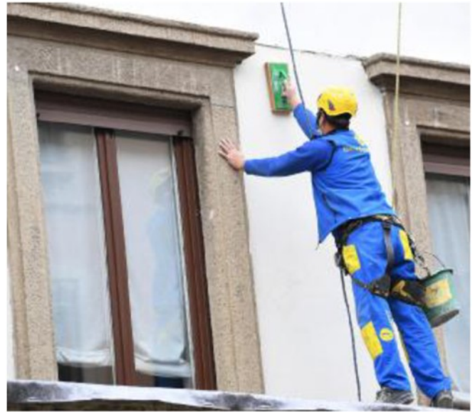
Edilizia Un operaio lavora alla facciata di un palazzo di Milano ANSA
